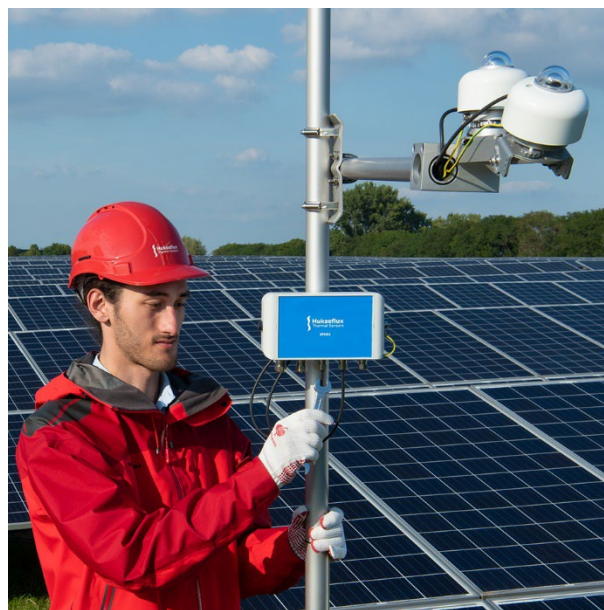
Rysunek 6 Dwa pyranometry SR300-D1 podłączone do urządzenia ochrony przeciwprzepięciowej SPD01. Dzięki opcjonalnemu urządzeniu SPD01 można zwiększyć odporność na przepięcia do poziomu 4.
